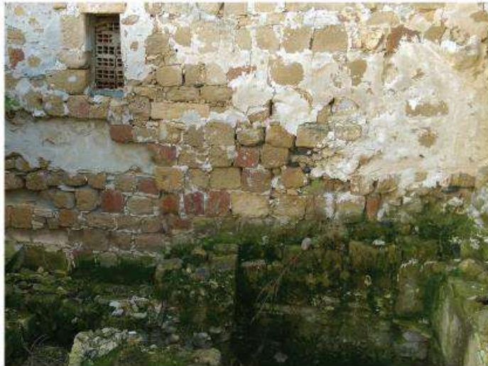
Λίθινη τοιχοποιία με εμφανή υγρασία και ανάπτυξη βλάστησης
