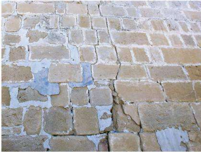
Λίθινη τοιχοποιία με εμφανείς ρηγματώσεις
