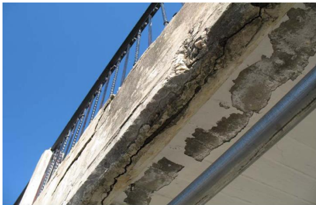
Εικόνα 4.1. Απεικονίζεται η ομοιόμορφη διάβρωση κατά μήκος της ράβδου οπλισμού.
