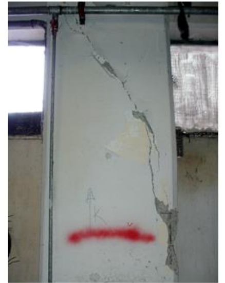
Φωτ. 6: Βαθμός βλάβης 3
