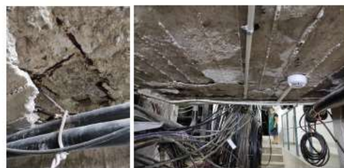
Φ.12: Ελλιπής επικάλυψη οπλισμού, εκτεθειμένοι οπλισμοί και κακή κατάσταση σκυροδέματος στην έξοδο καλωδίων του υπογείου (δυτική πλευρά)
