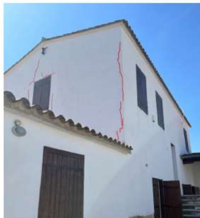
Φ.10: Εντονες κατακόρυφες ρωγμές στη εξωτερική γωνιά της τοιχοποιίας του ορόφου και τριχοειδής ρωγμές επιχρίσματος γύρω από το άνοιγμα. Παράλληλα, στη συγκεκριμένη βόρεια όψη του ορόφου, παρατηρείται συμπλήρωση ρωγμών από προηγούμενη φάση επεμβάσεων κάτι που υποδηλώνει πως ο όροφος επιδιορθώθηκε και δεν ανακατασκευάστηκε όπως αναγράφεται στα στατικά σχέδια.
