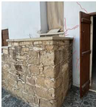
Φ.7: Τριχοειδής ρωγμές τοιχοποιίας και τοπική αποκόλληση επιχρίσματος.
