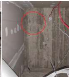
Φ.5: Εντοπίζονται εκτεταμένοι οπλισμοί σε μεμονωμένα σημεία στην πλάκα άνωθεν ισόγειου
