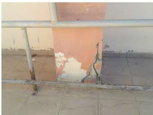
Φ.6: Αποσάθρωση και εκτεταμένου εύρους ρηγμάτωση σε υποστυλώματα (Νότια όψη κύριας κατασκευής)
