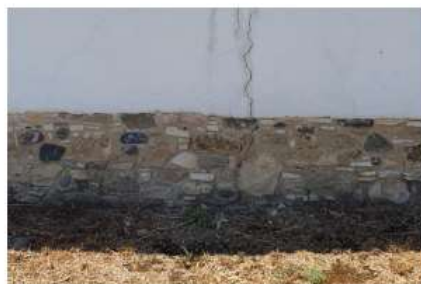
Φ.9: Εντονες κατακόρυφες ρωγμές τοιχοποιίας που φτάνουν μέχρι τα θεμέλια και διασχίζουν τη λιθοδομή ακολουθώντας τον αρμό των λιθασωμάτων. Υπάρχει η υποψία ότι πρόκειται για επιφανειακή θεμελίωση.
