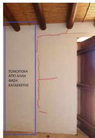
Φ.9: Τριχοειδής ρωγμές επιχρίσματος που φαίνεται να διαχωρίζουν τη νεότερη φέρουσα τοιχοποιία από ωμόπλινθο με αυτή που επισκευάστηκε σύμφωνα με τα στατικά σχέδια μελέτης αποκατάστασης που υλοποιήθηκε το 2008. Οι δύο φάσεις κατασκευής της τοιχοποιίας είναι διακριτές και από τη διαφορά χρωματισμού του επιχρίσματος.
