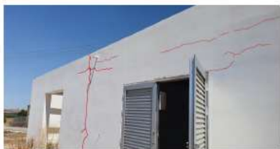
Φ.2: Οριζόντιες τριχοειδής ρωγμές επιχρίσματος πάνω από το ανώφλι ανοίγματος και πιο έντονη κατακόρυφη ρωγμή στο σημείο ένωσης του τοίχου με εγκάρσιο εσωτερικό.
