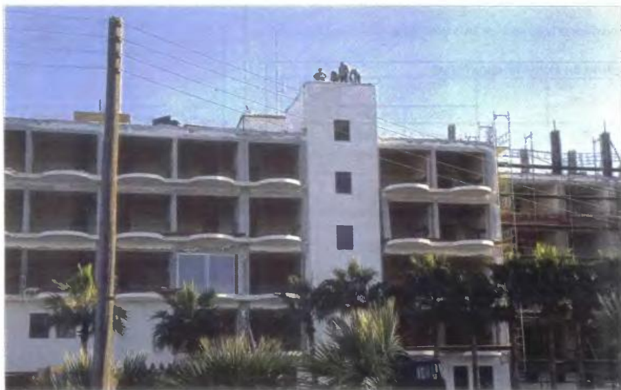
Η φωτογραφία προσκομίστηκε στην Επιτροπή Εσωτερικών από τον Α' αντιπρόεδρο του ΕΤΕΚ. Εργάτες δουλεύουν στην οροφή πολυώροφης οικοδομής χωρίς κράνη ή άλλα προστατευτικά μέτρα.
