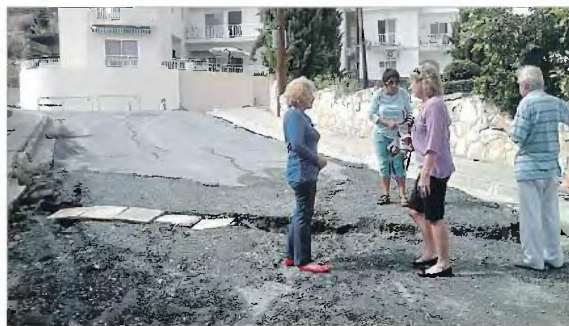
Η υποχώρηση του εδάφους στο Πισσούρι έχει προκαλέσει ανεπανόρθωτες ζημιές σε δεκάδες κατοικίες.
