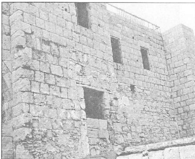
Αποψη της κατεχόμενης Μονής Απ. Ανδρέα. Η φθορά της λιθοδομής βρίσκεται σε προχωρημένο στάδιο.
