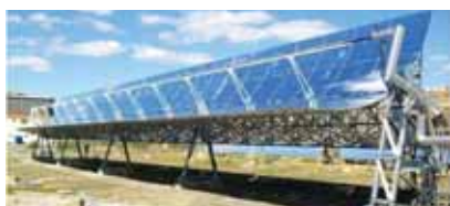
Ηλιοθερμική τεχνολογία ηλεκτροπαραγωγής με κοίλα παραβολικά κάτοπτρα.
