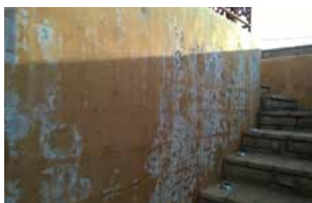
Υγρασίες σε τοίχο υπογείου που εφάπτεται με κήπο.
