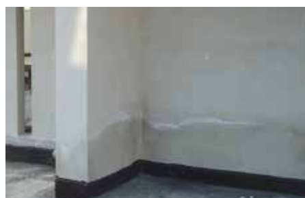
Υγρασίες σε πυλωτή ισογείου.
