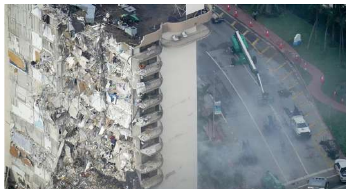
Μερική κατάρρευση πολυώροφου συγκροτήματος κτιρίων στο Μαϊάμι στη Φλόριντα. Πηγή: https://apnews.com/article/business-building-collapses-technology-ef5b013114b766b7ed1e88a5b27c501f/gallery/a64a2f5191454f19a2037a94ecdcbdd22
